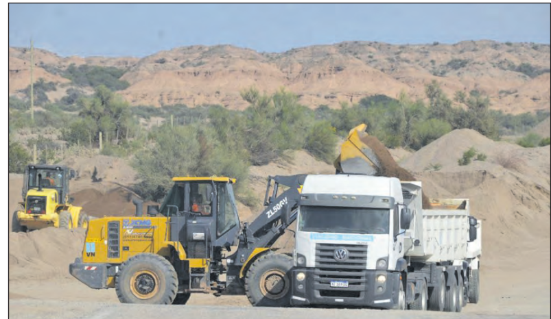
Con estas intervenciones, se previenen inundaciones en Villa Mazán, además de garantizar la transitabilidad de la RN 60 ante crecidas.
